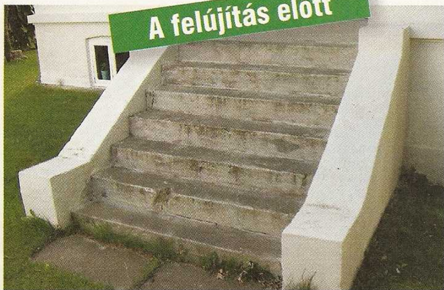
A lépcső eredeti állapotában már nem volt szép, viszont erős volt, és néhány repedéstől eltekintve az állaga is megfelelt.
