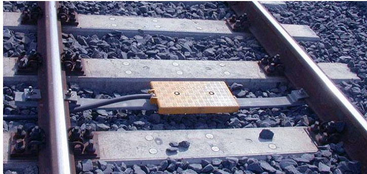
7. ábra – Vezérelhető balíz, kábelezve
