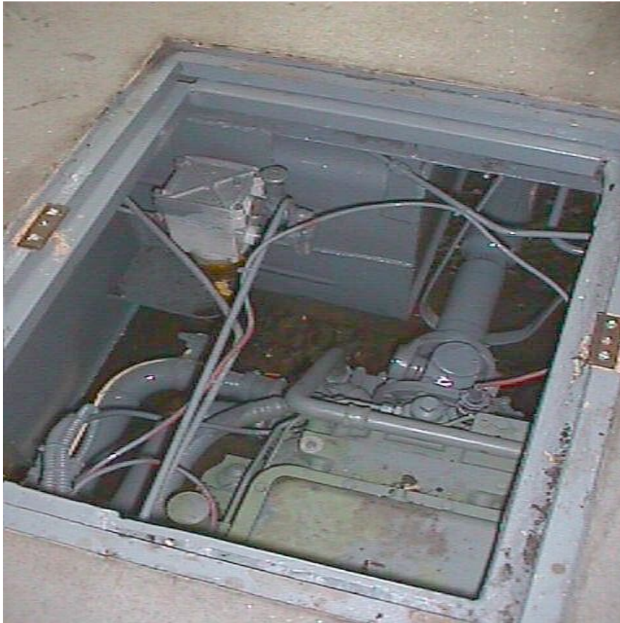
5. ábra SEPAR szűrő a tápszivattyúval
